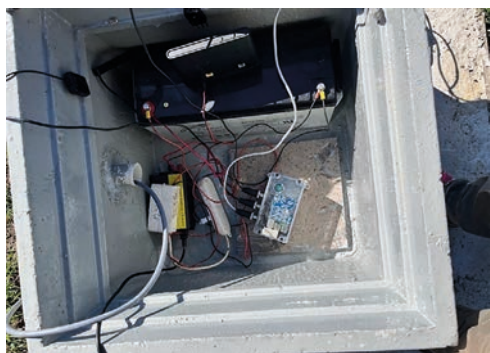
Uno de los equipos instalados en el país.
